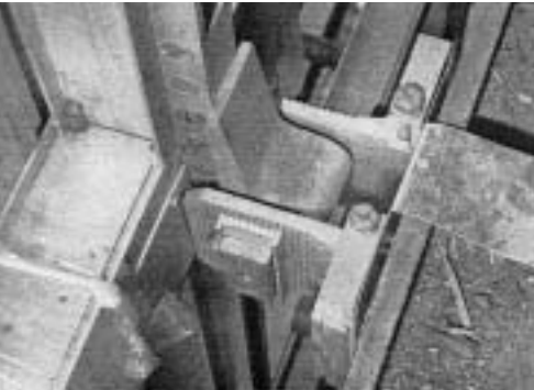
37. Il giunto di attacco alla struttura del curtain wall del grattacielo Pirelli a Milano
